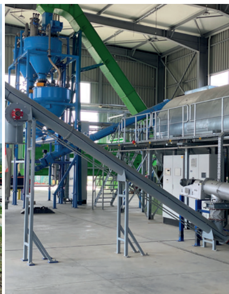
Anlage am Standort Bulgarien „Plastic to Oil“
